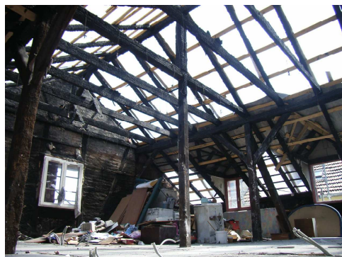
Sinistre de l'immeuble 2 rue de la Bonde ayant détruit 14 logements.
